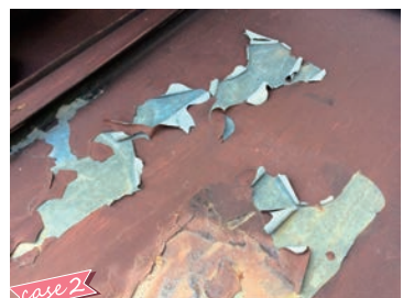
塗膜が剥がれて屋根の素地が見えている
