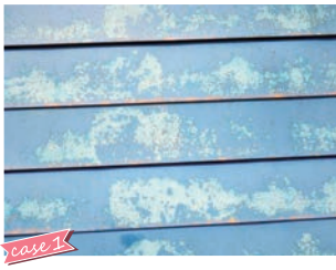
塗装が剥がれ、以前、塗り替えた塗膜が見えている
