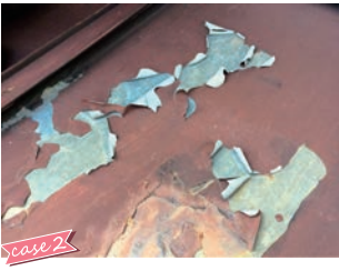
塗膜が剥がれて屋根の素地が見えている
