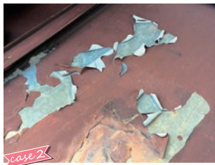
塗膜が剥がれて屋根の素地が見えている
