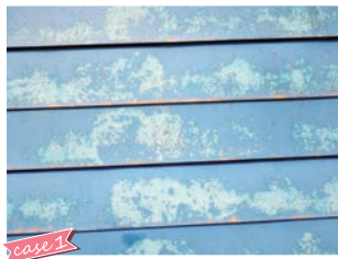
塗装が剥がれ、以前、塗り替えた塗膜が見えている
